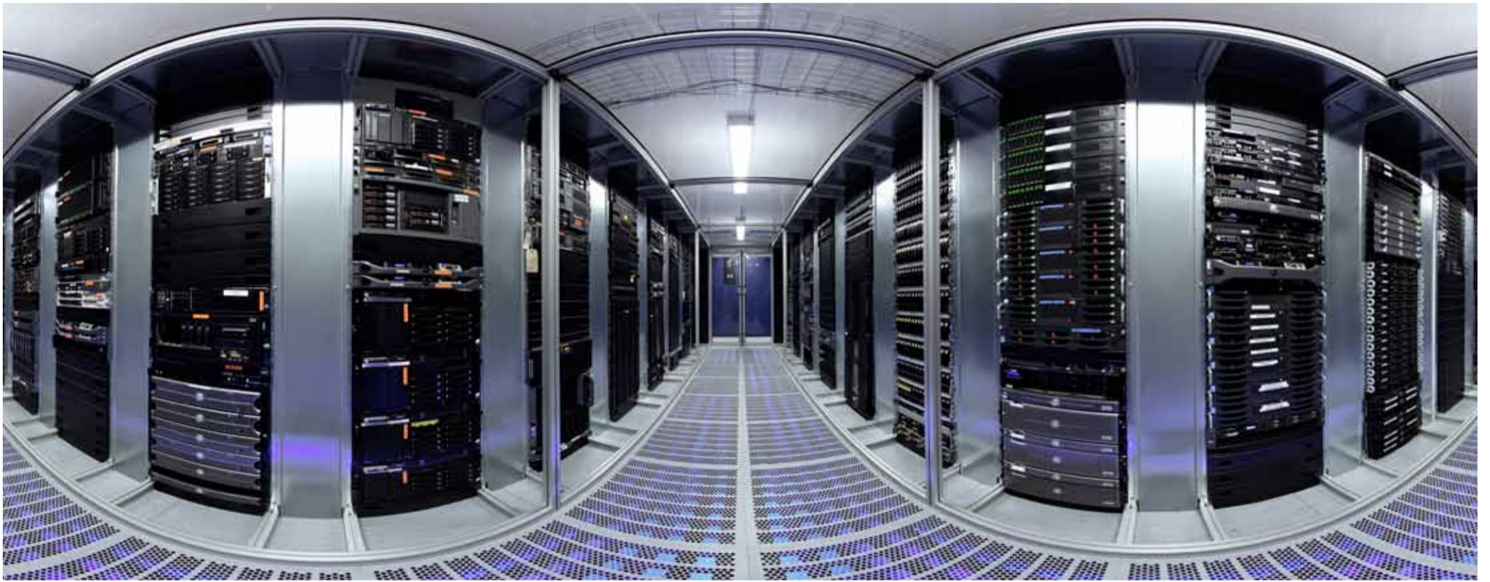
Einer der größten Verbraucher in Rechenzentren ist die Kühlung, die knapp ein Drittel des Energiebedarfs ausmacht – alleine in Deutschland sind das pro Jahr drei Terawattstunden (TWh).
